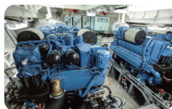
기관설비 Engine Room
