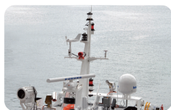
항해 및 통신설비 Navigation & Radio Equipment
