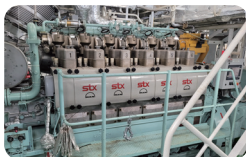
기관설비 Engine Room
