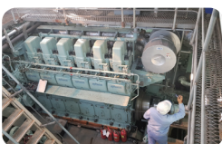
기관설비 Engine Room
