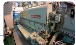
기관설비 Engine Room
