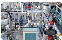
연료공급설비 Gas Processing Room
